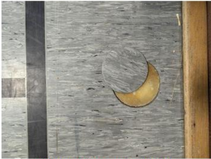
Bild 4: Beschädigung am Gerätedeckel
