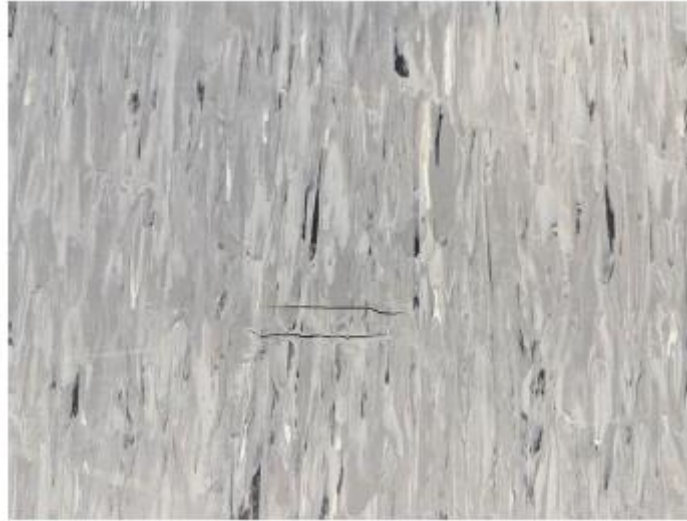
Bild 5: Beschädigung im Oberbelag
